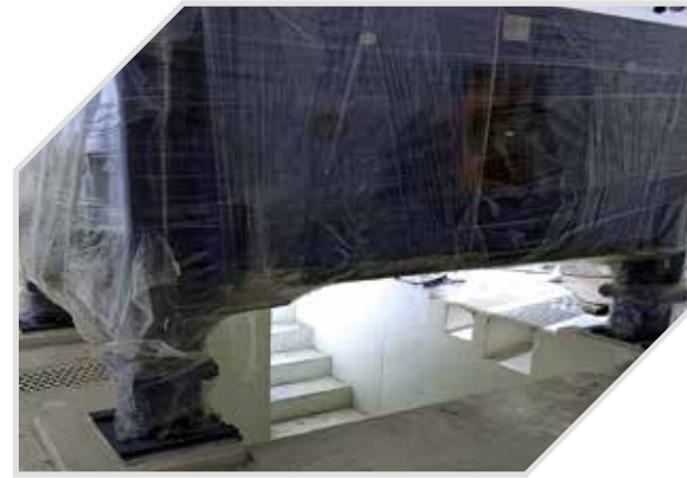
Imagen 2: Estado de los equipos del CCRP 2020
